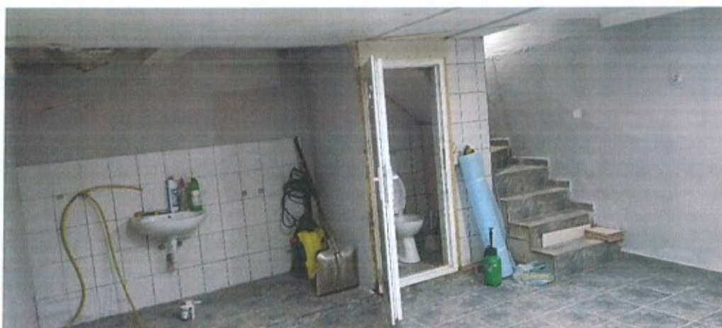
Foto 5. Foto e njëjës sanitare në bodrum, mars 2023
